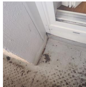
Hålkäl mot balkongdörr.
