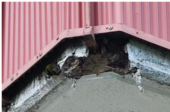
Kraftig spjälkning runt korroderat räcketfäste.
